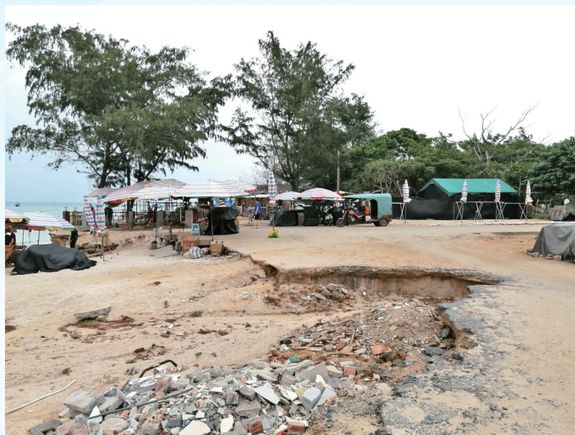
图 7 石螺口至滴水村岸段侵蚀情况（2019 年 10 月底）
