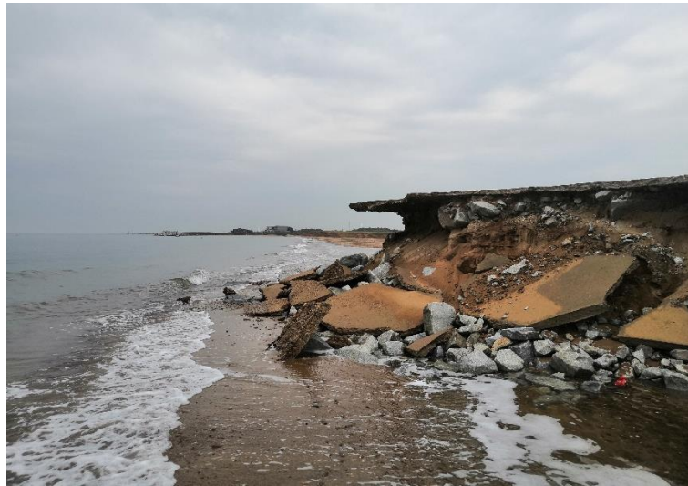
图 38 辽宁绥中南江屯岸段海岸侵蚀
